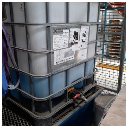
2. IBC (1000 L. tank) med sprinklervæske
